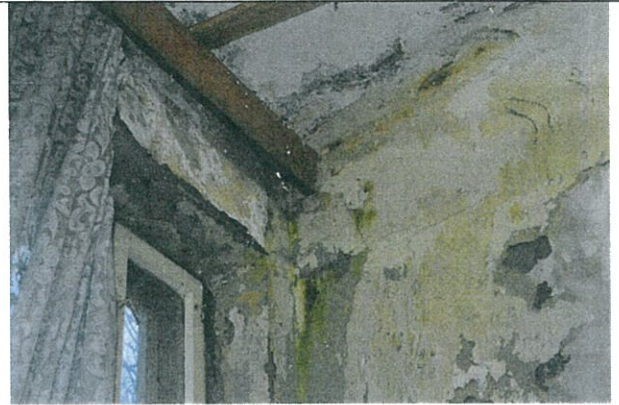
Fig. 18 Infiltrații la etaj
