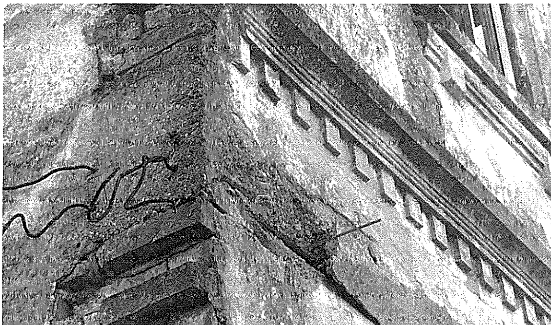
Fisuri orizontale la nivelul centurilor
