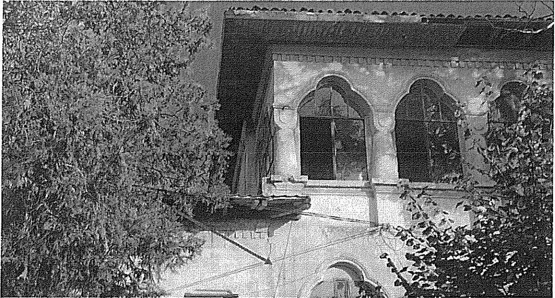
Fisuri in peretele perimetral ca urmare a tasarii diferite data de regimul de inaltime diferit
