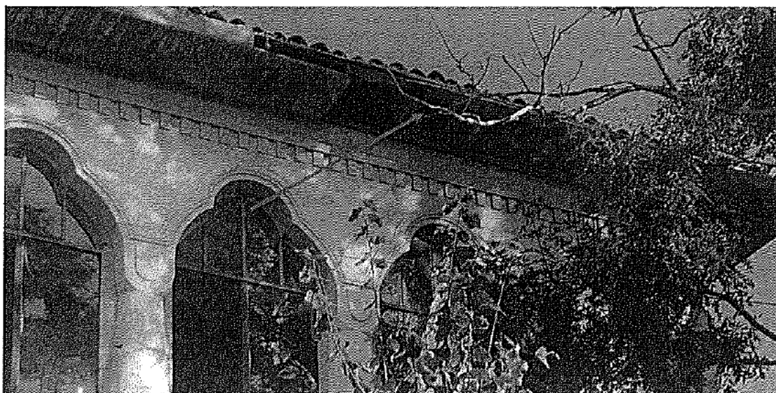
Degradari la nivelul sarpantei
