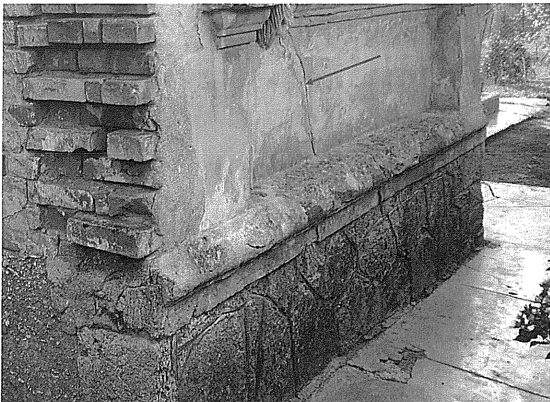
Fisuri in peretii de zidarie ca urmare a tasarilor diferite
