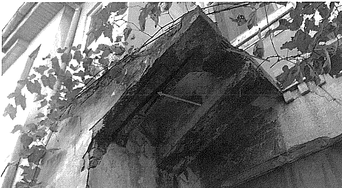
Degradarea betonului si a armaturilor
