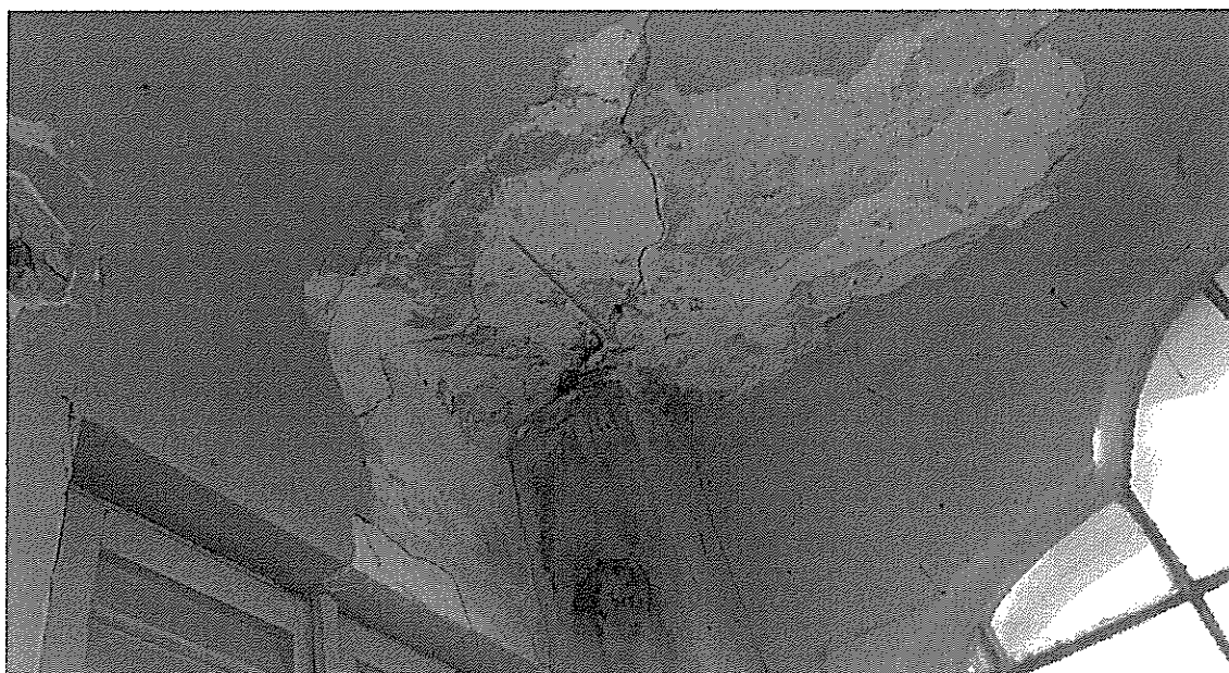
Fisuri in planseul de beton armat continuate in peretii de zidarie
