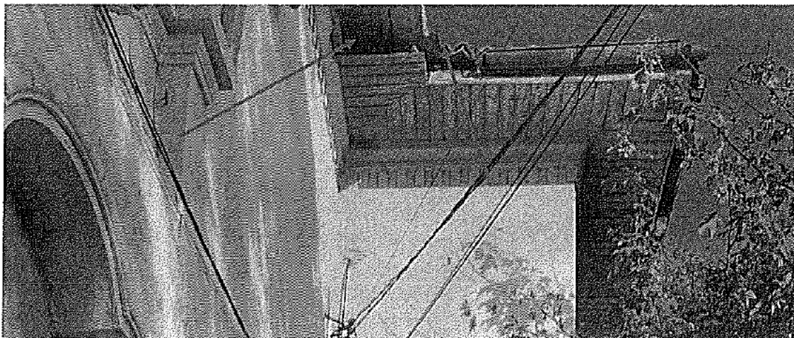
Degradari la nivelul sarpantei si a invelitorii
