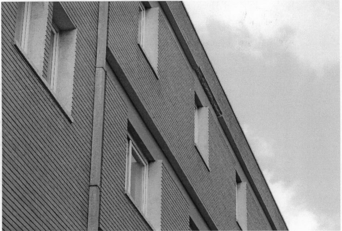
Figura 4 Latura de sud a clădirii-zonă de unde a căzut tencuiala în luna august 2012
